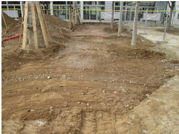
1. Estat de sauló i graves a la banda NO
